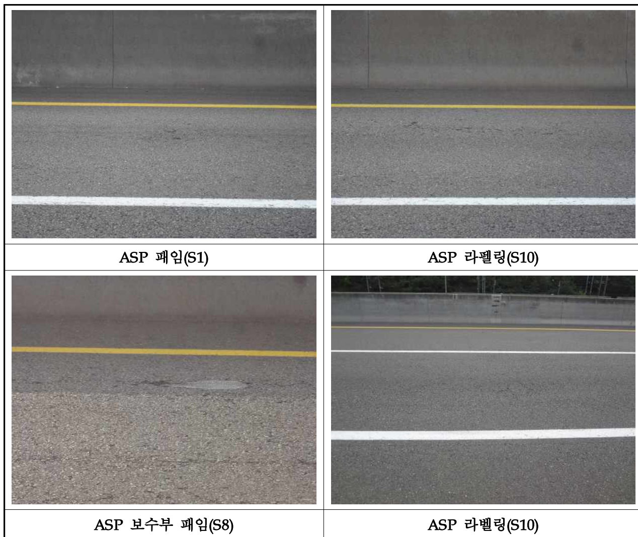
【사진 3.2.18】 교면포장 손상현황(대구)
