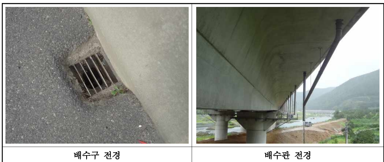
【사진 3.2.19】 배수구 및 배수관 전경(대구)
