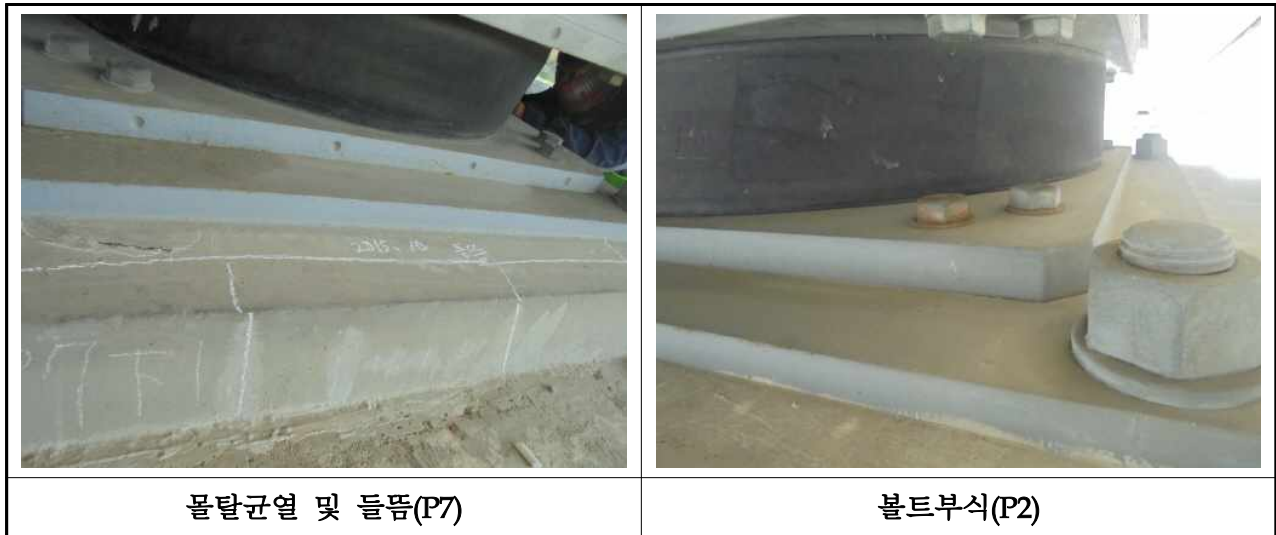
【사진 3.3.13】 교량받침 손상현황(부산,계속)
