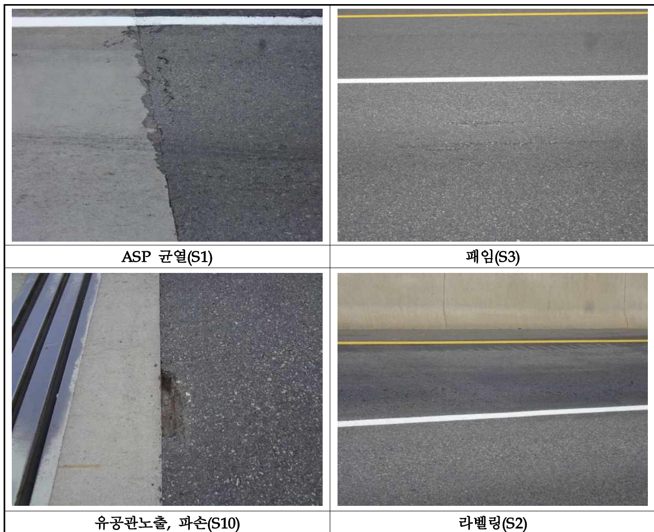
【사진 3.3.18】 교면포장 손상현황(부산)
