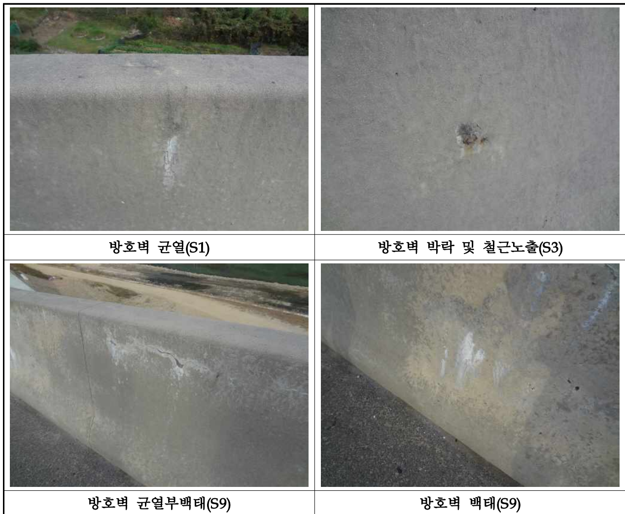
【사진 3.2.21】 방호벽 손상현황(대구)
