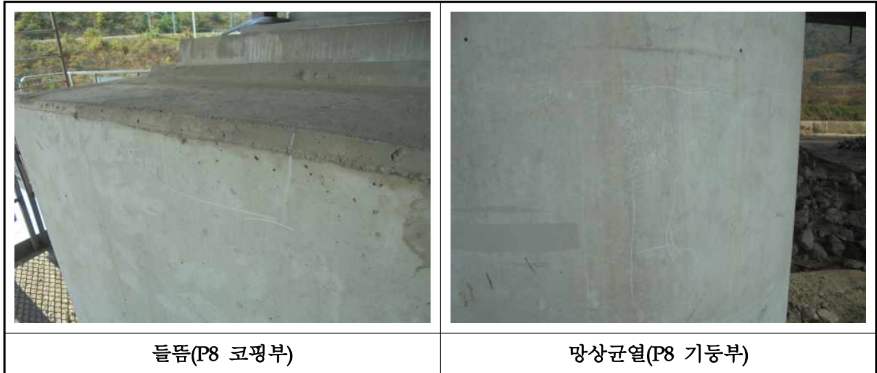
【사진 3.3.11】 교각 손상현황(부산,계속)
